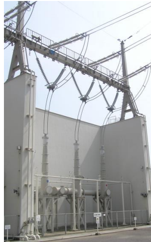
220kV 送電線引込部（イメージ）
