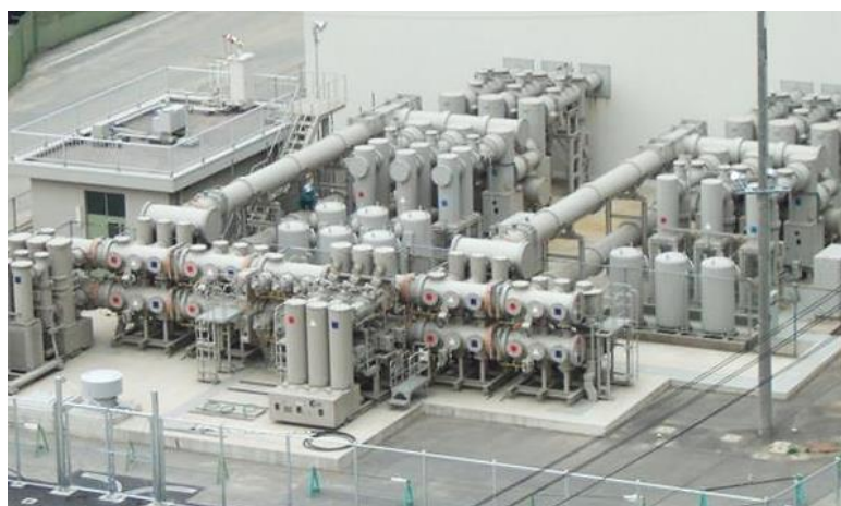
図 3-8 220kV 開閉所の外観
