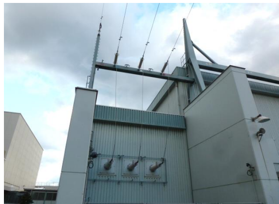
66kV 送電線引込部（イメージ）
