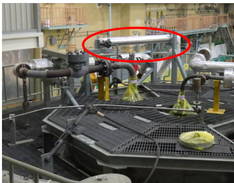
図 1 ベント配管の設置例
