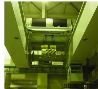
原子炉建物天井クレーン
