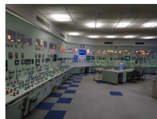
直流非常灯点灯時
