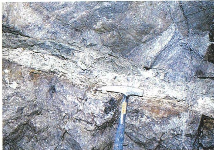
写真-1.14 白亜紀の花崗岩中の低角度断層に沿う熱水変質(低角度断層沿いに熱水変質を受けて白色の粘土鉱物を生じて軟弱化しているため、堤体の安定性に大きな影響を与える)
