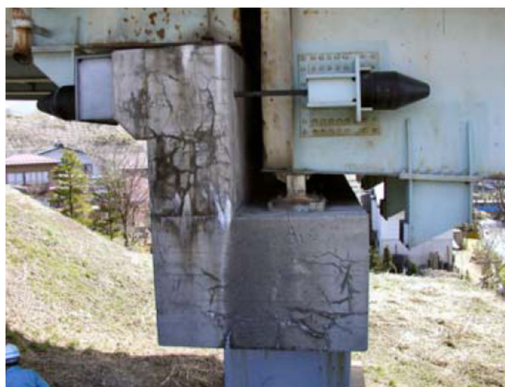
図3. 2. 4-2 実構造物における膨張ひび割れ（亀甲状）の事例 7)
