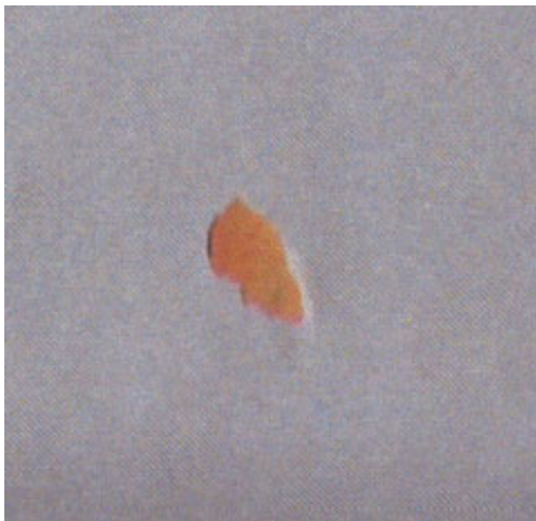
フロー②と判断した塗膜の劣化
