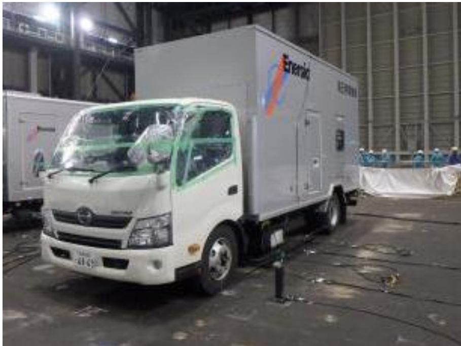
図 3-5 試験構成（高圧発電機車（タイプ I））（4/10）
