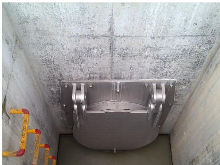
(屋外排水路逆止弁⑩の設置状況)
