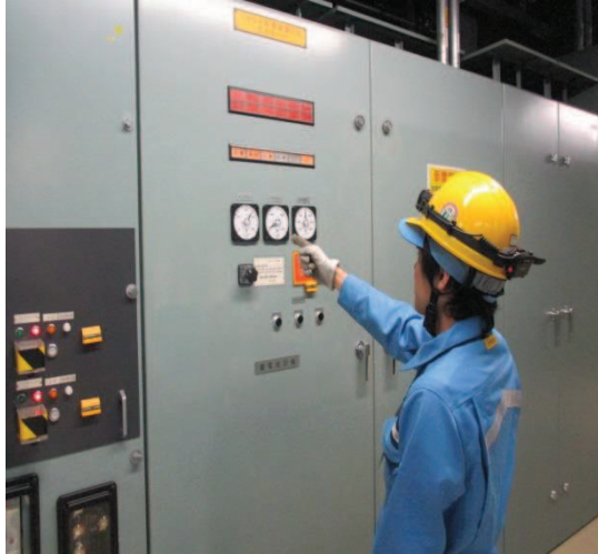
125V 代替充電器の受電状態確認
