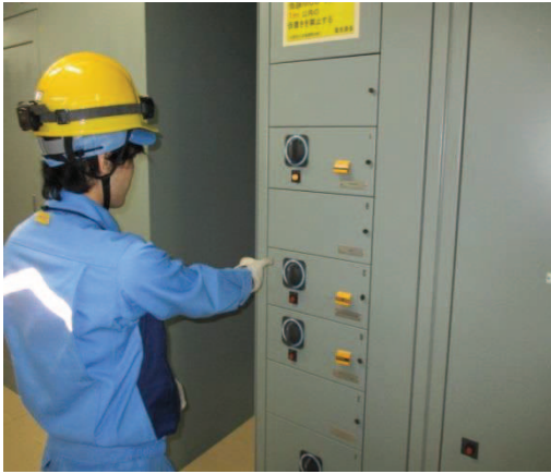
MCC 負荷の切離し操作
