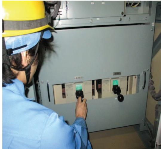
125V 代替蓄電池の切操作
