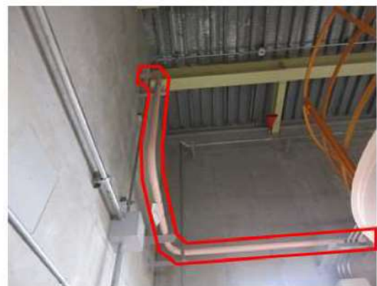
ディーゼル発電機燃料油サービスタンク 燃料油ベントライン (原子炉建屋敷設状況)
