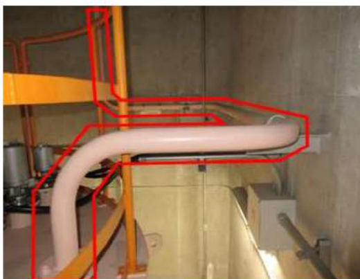
ディーゼル発電機燃料油サービスタンク 燃料油ベントライン (燃料油サービスタンク周辺敷設状況)
