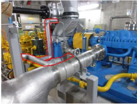
タービン動補助給水ポンプ (低圧ステムリーク・グランド蒸気リーク排気管①)
