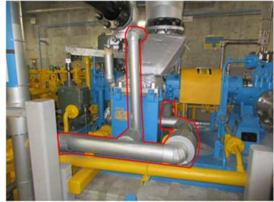
タービン動補助給水ポンプ (低圧ステムリーク・グランド蒸気リーク排気管②)
