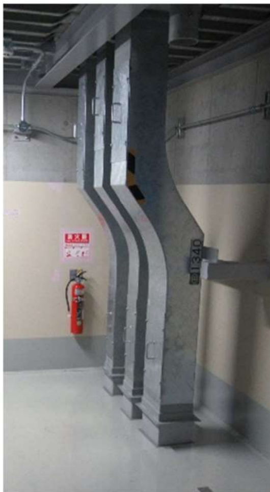
第 2-1 図 ケーブルトレイ床貫通部外観
