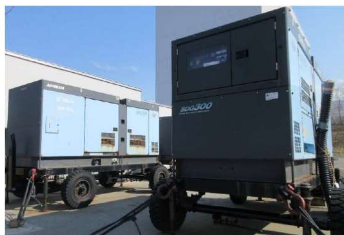
図4-11 緊急時対策所用発電機 外観
