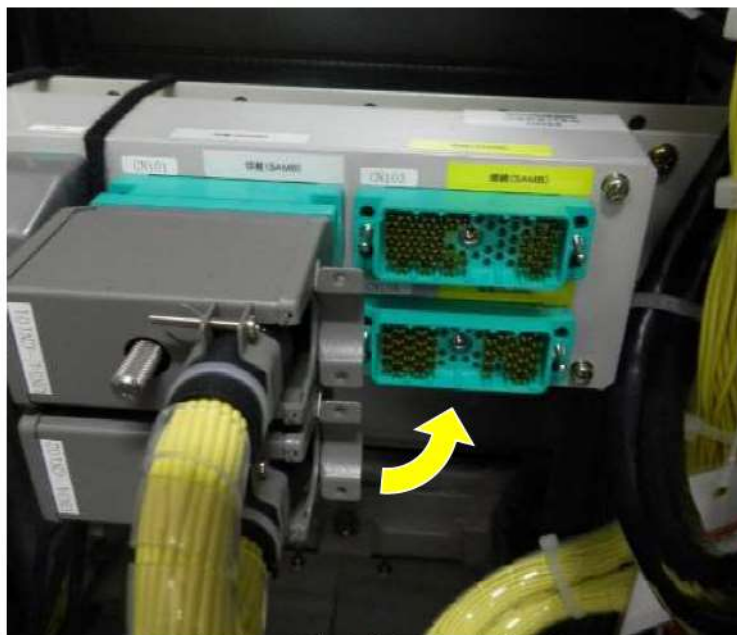
(1次系制御監視盤内 切替器)
