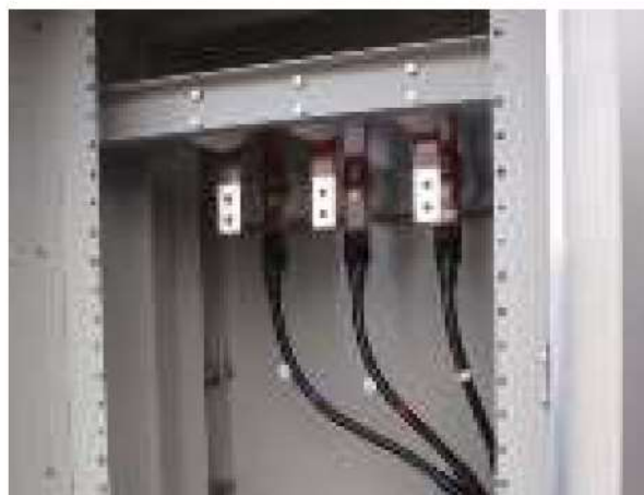
図 57.12.4 号炉間連絡予備ケーブル接続箇所
