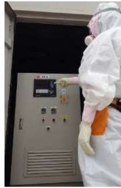
代替非常用発電機起動 (屋外)
