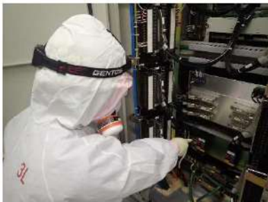
不要直流負荷の切離し操作 (安全系計装盤室) (原子炉補助建屋T. P. 17. 8m)
