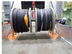
号炉間連絡予備ケーブル
