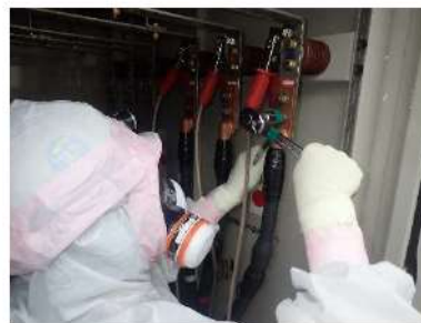
号炉間連絡ケーブル接続（端子） （屋外）
