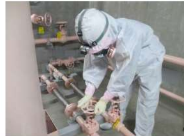
燃料補給系統構成 (ディーゼル発電機燃料油サービスタンク室) (周辺補機棟T. P. 17. 8m)
