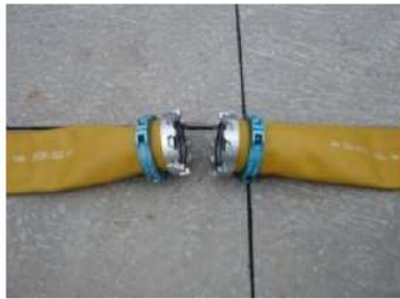
可搬型ホース（150A）接続前
