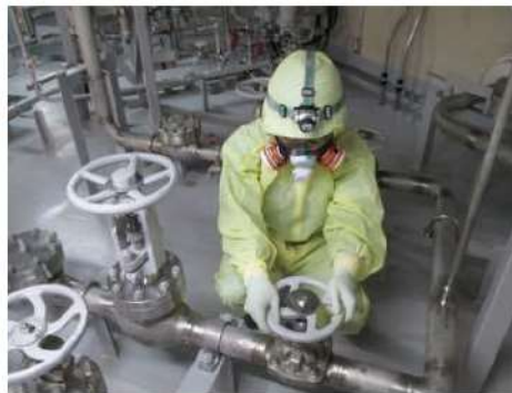
燃料取替用水ピット 補給ライン系統構成 (周辺補機棟 T.P. 17.8m (中間床))
