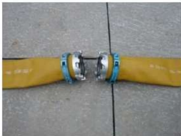
可搬型ホース（150A）接続前
