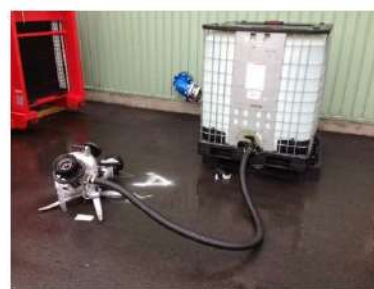
小型放水砲及び泡消火薬剤
