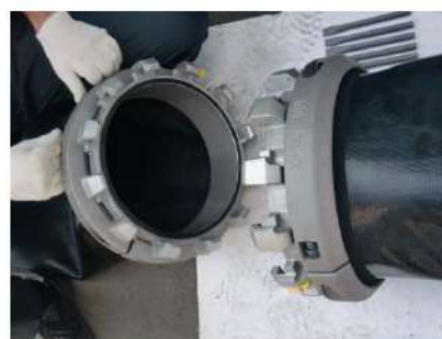
可搬型ホース(300A)接続
