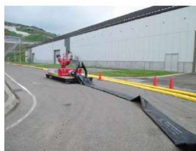
放水砲設置 (屋外)
