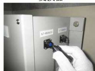
ケーブル接続 BOX
