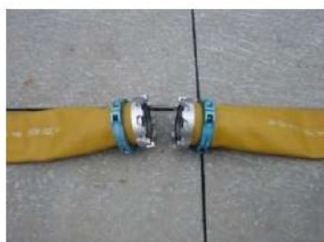
可搬型ホース（150A）接続前
