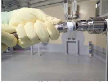
アニュラス排気ダンパのカプラ接続イメージ (周辺補機棟 T. P. 40. 3m)
