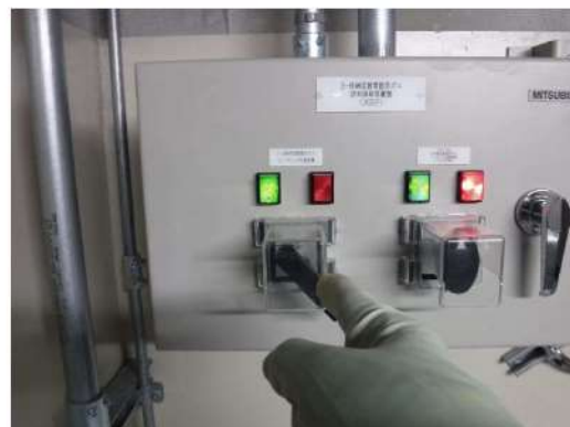
格納容器雰囲気ガスサンプリング圧縮装置起動 (周辺補機棟 T. P. 24. 8m)
