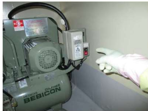
可搬型代替ガスサブリング圧縮装置起動 (周辺補機棟 T. P. 24. 8m)
