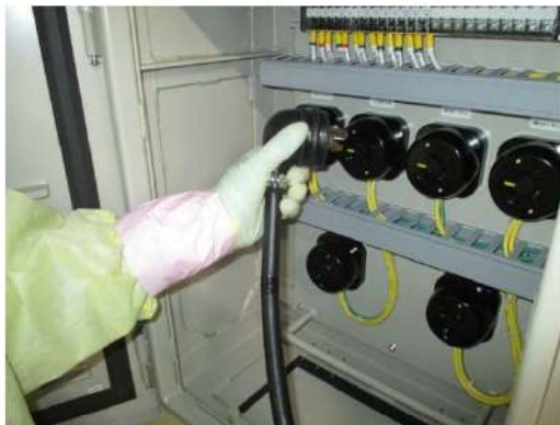
原子炉格納容器水素濃度監視電源操作 (周辺補機棟 T. P. 24. 8m)
