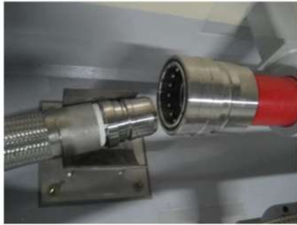
消火水系配管と格納容器スプレイ系配管との接続のための可搬型ホース接続 前 (運転員(現場) B) (原子炉補助建屋 T. P. 10. 3m)
