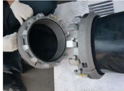
可搬型ホース(300A)接続
