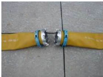
可搬型ホース (150A) 接続前
