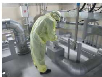
可搬型大型送水ポンプ車による 原子炉容器への注水 系統構成 (運転員 (現場) B) (原子炉補助建屋 T.P. 10.3m (中間床))
