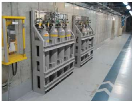
主蒸気逃がし弁操作用 可搬型空気ポンベ (周辺補機棟 T. P. 10. 3m)
