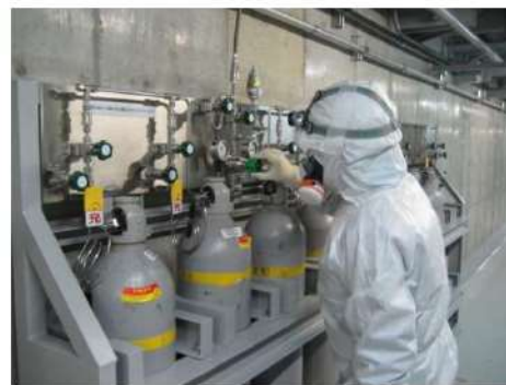
主蒸気逃がし弁 代替制御用空気供給操作 (周辺補機棟 T. P. 10. 3m)
