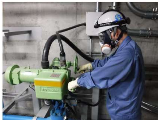
補助給水ライン流量調整 （周辺補機棟 T.P. 10. 3m（中間床））
