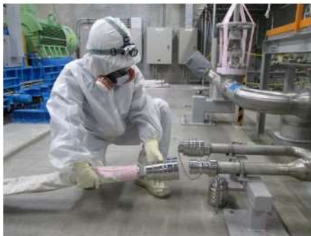
可搬型ホース接続 (周辺補機棟 T. P. 24. 8m)
