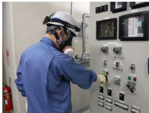
制御棒駆動装置用電源出力遮断器開放 （周辺補機棟 T.P. 17.8m）
