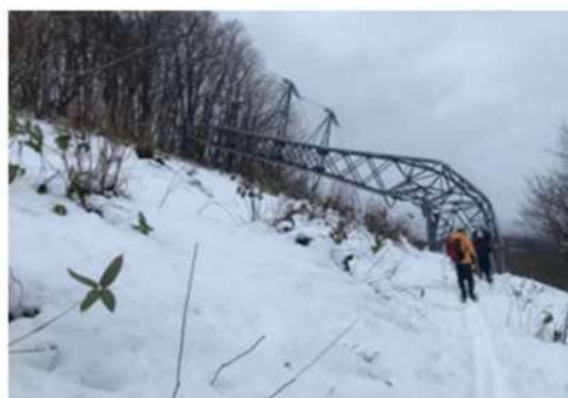
大雪による鉄塔倒壊事例 ※3
