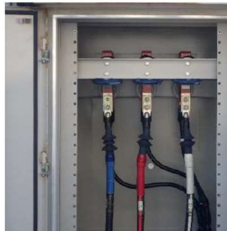
ボルト・ネジ接続 (代替交流電源)
