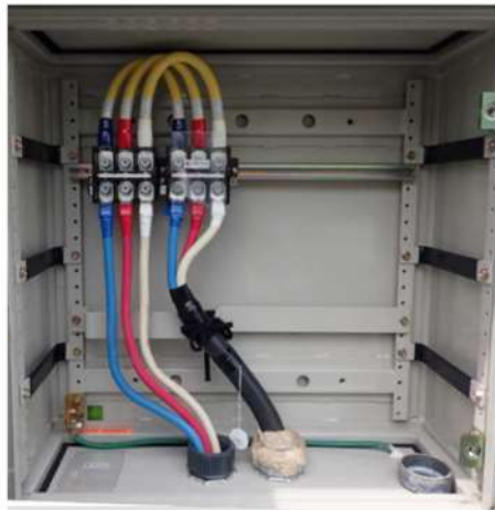
ボルト・ネジ接続 (代替直流電源)
