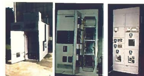
メータ パワーセンタ コントロールセンタ
