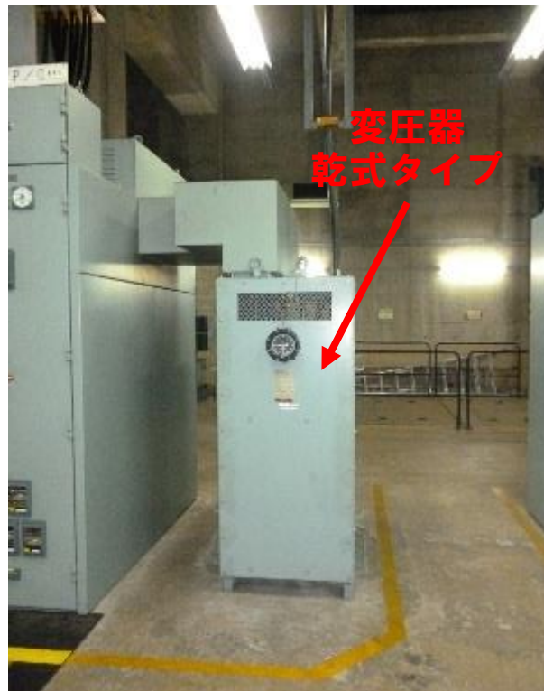
第 3.1 図 変圧器の一例
