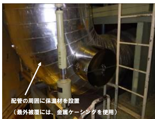
( 1 次主冷却系の配管 )
