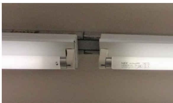
第2図 中央制御室天井照明
