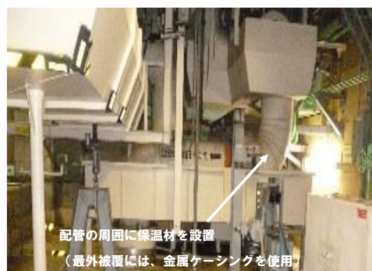
( 2 次主冷却系の配管 )
