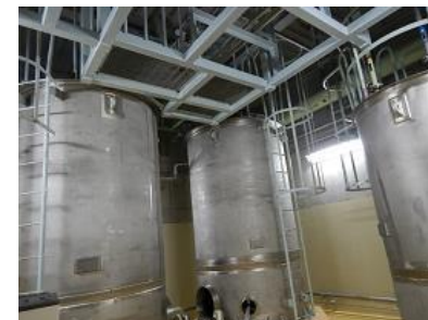
廃液調整タンク
