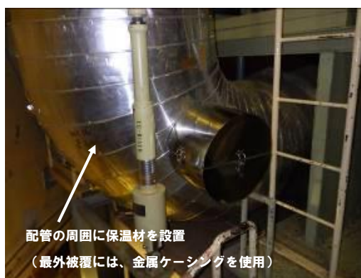
( 1 次主冷却系の配管 )
