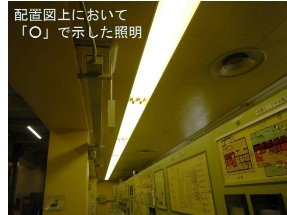
避難用照明（ディーゼル発電設備から給電）
