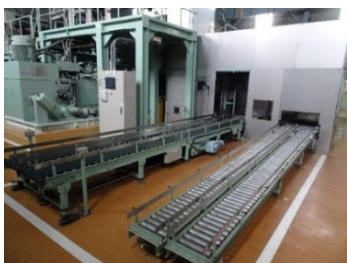
廃棄物搬送設備
