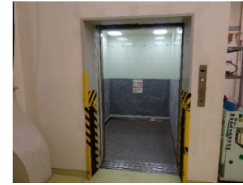
廃棄物搬送用 エレベータ
