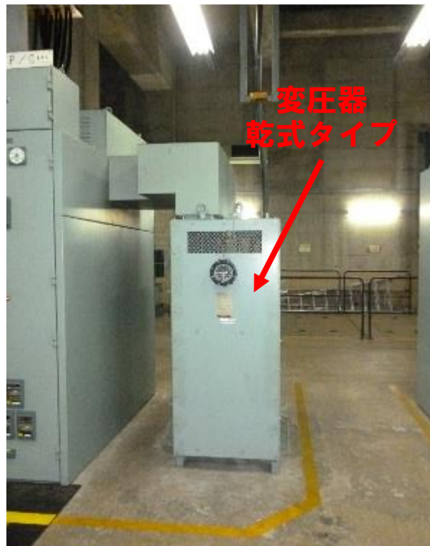
第 3.1 図 変圧器の一例
