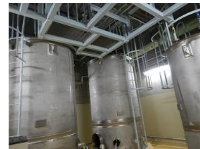
廃液調整タンク
