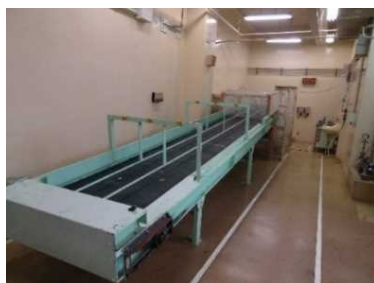
固体廃棄物投入機
