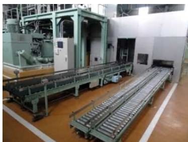
廃棄物搬送設備
