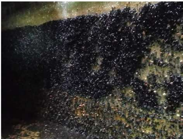
(参考：新たな貝が付着した状態) 2012年定検時の除貝前の壁面写真 ※循環水ポンプ停止運用前 黒色部分は全て貝
