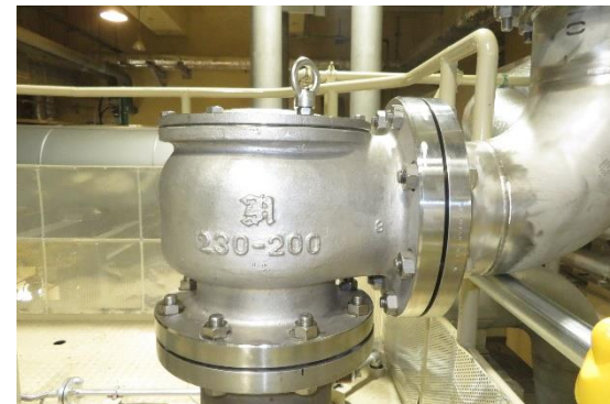
焼却・溶融設備の溶融炉及び焼却炉の圧力逃し弁の構造
