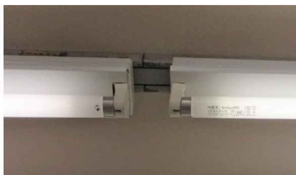
第2図 中央制御室天井照明
