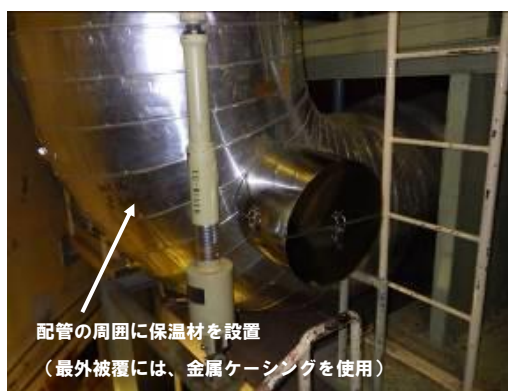
( 1 次主冷却系の配管 )
