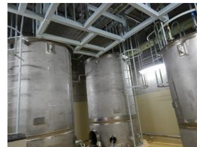
廃液調整タンク
