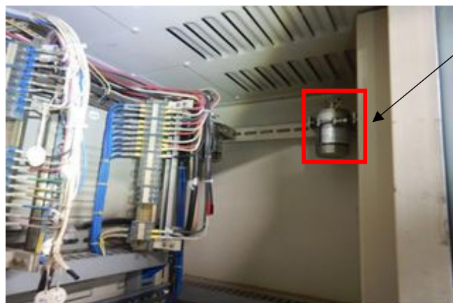
第1-3図 エアロゾル消火設備の電気盤への設置例
