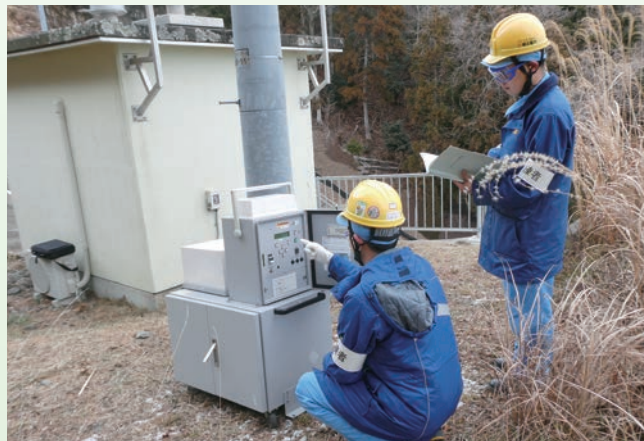
発電所の敷地境界付近に可搬型モニタリングポストを設置し、放射線量を測定
