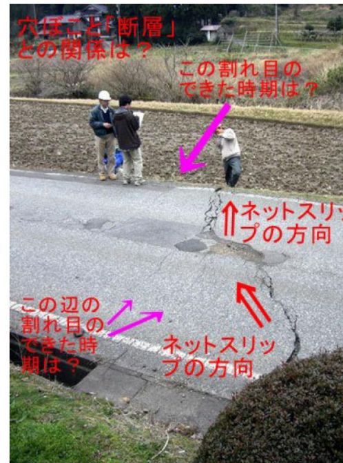
「断層」とされる道路の割れ目の写真(川辺ほか, 2007)
