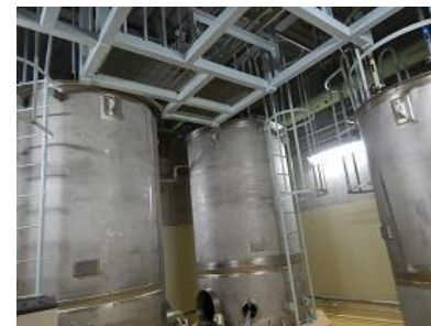
廃液調整タンク
