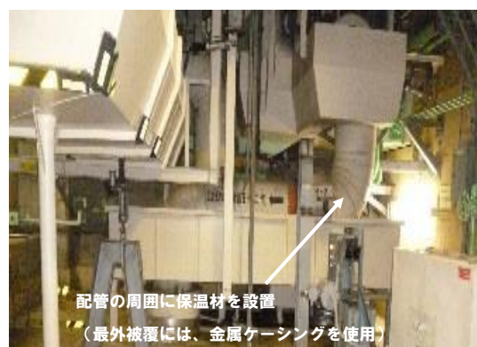
( 2 次主冷却系の配管 )
