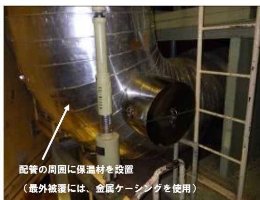
( 1 次主冷却系の配管 )
