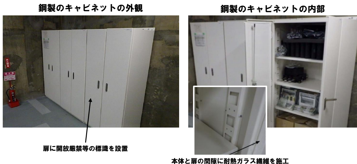
第 7.1 図 鋼製のキャビネットの設置イメージ
