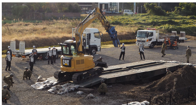
支援センター保有無線重機 通行可
