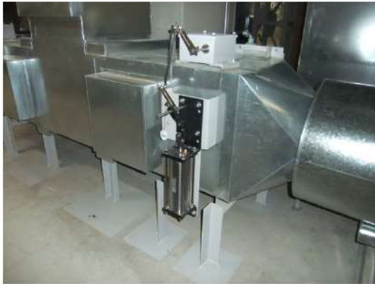
ダンパ全景 (原子炉補助建屋T. P. 24.8 m) (開操作対象ダンパの一例)
