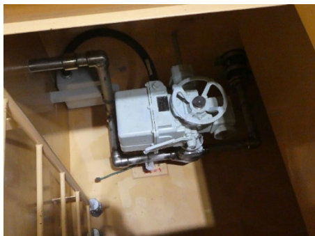
補給水設備自動弁
