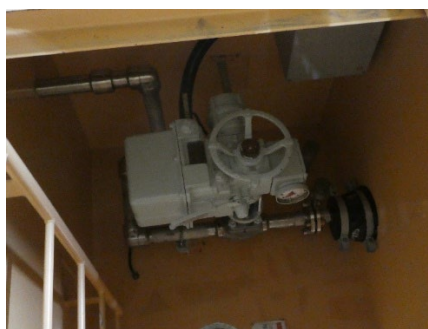
補給水設備自動弁
