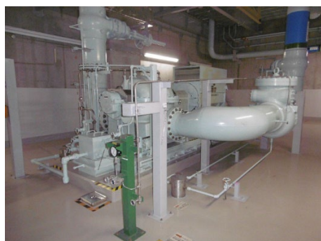
安全冷却水系冷却水循環ポンプ C
