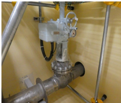
プール水冷却設備自動弁
