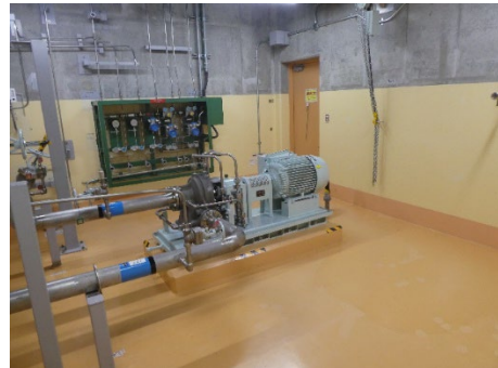
補給水設備ポンプA
