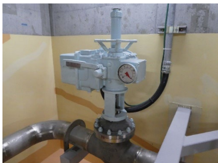
補給水設備自動弁
