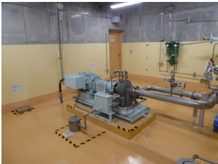
補給水設備ポンプB
