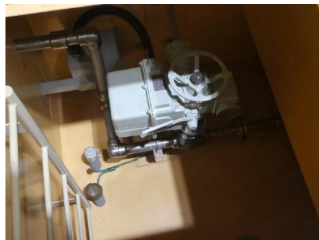
補給水設備自動弁
