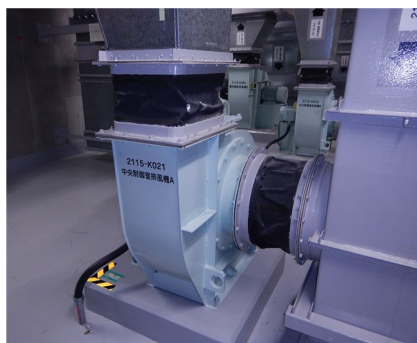
中央制御室排風機 A
