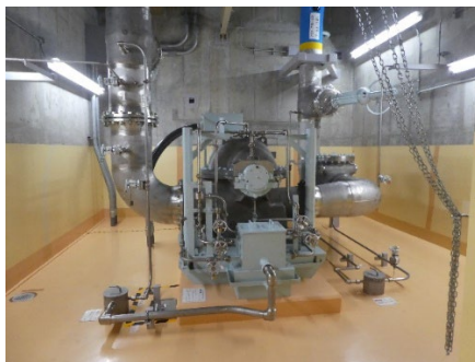
プール水冷却系ポンプC
