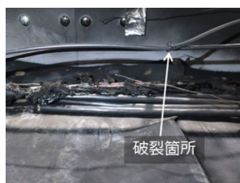
(感知チューブ溶損箇所)
