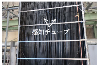
(感知チューブ溶損箇所)
