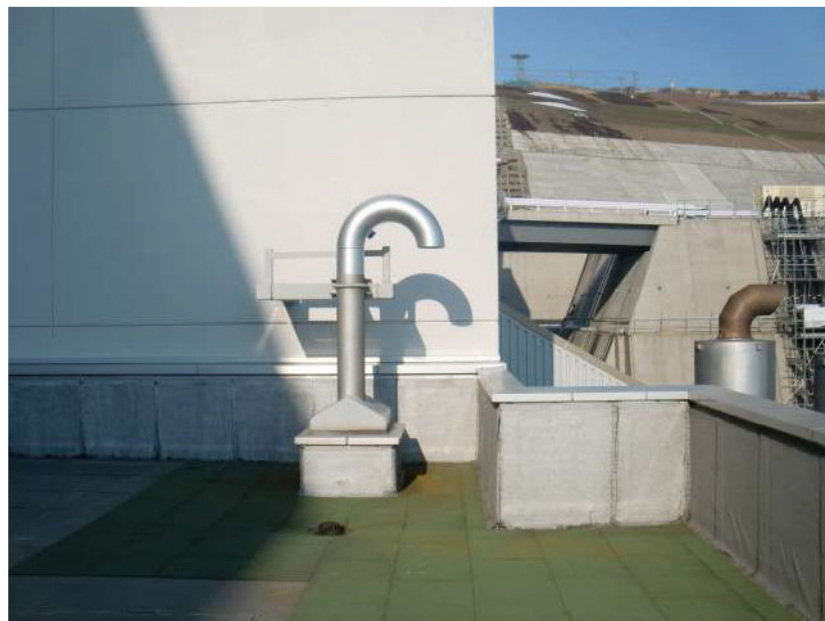
図1 タービン動補助給水ポンプ排気管の設置状況
