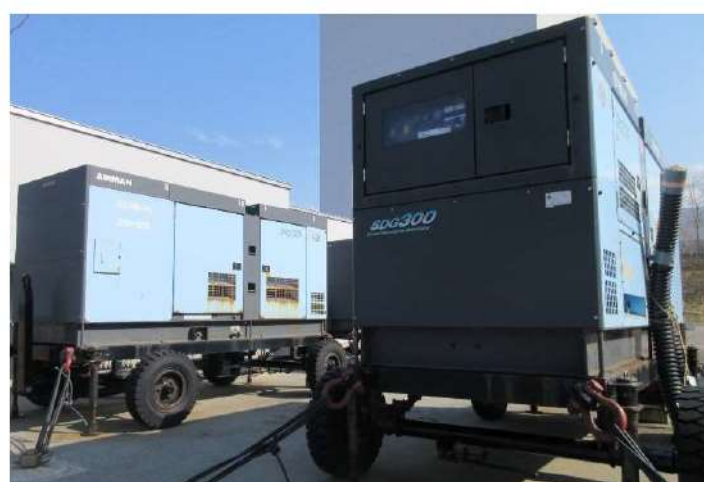
図4-11 緊急時対策所用発電機 外観
