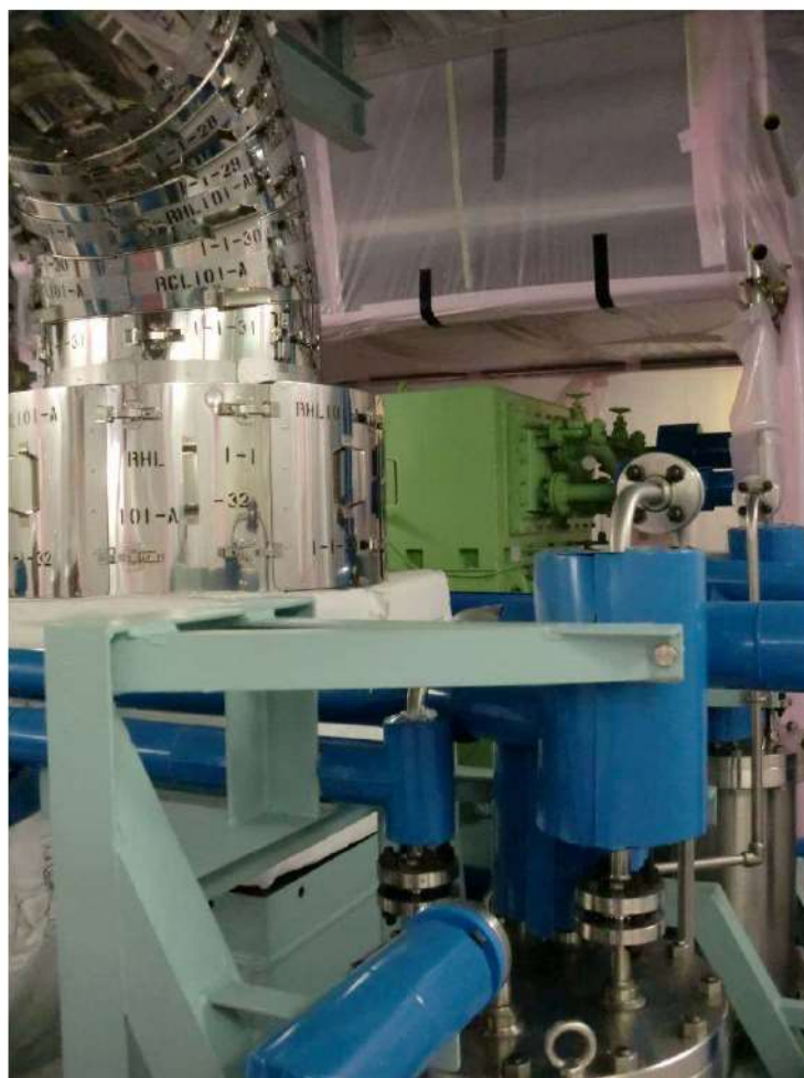
余熱除去ポンプ 外観
