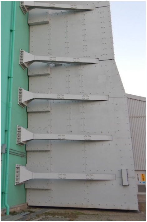
建屋壁面と地表面の隙間状況
