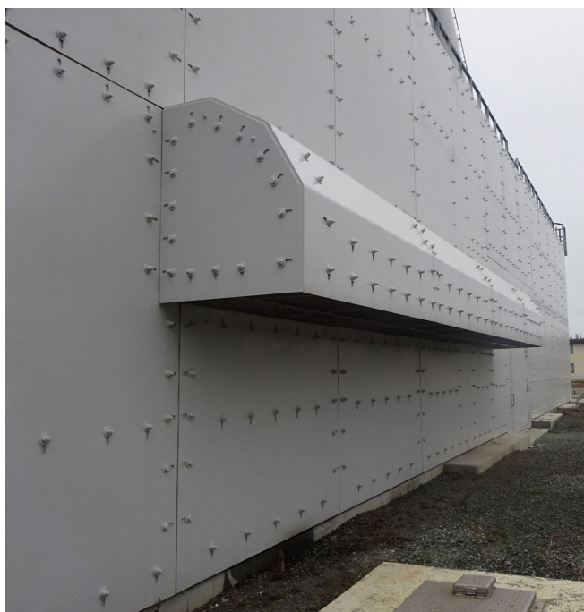
フード（吸気側）の設置状況
