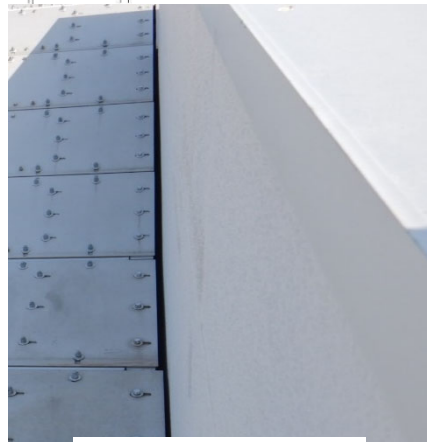
建屋近傍の隙間状況
