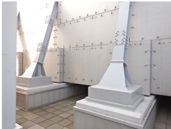
建屋 屋上面との隙間状況
