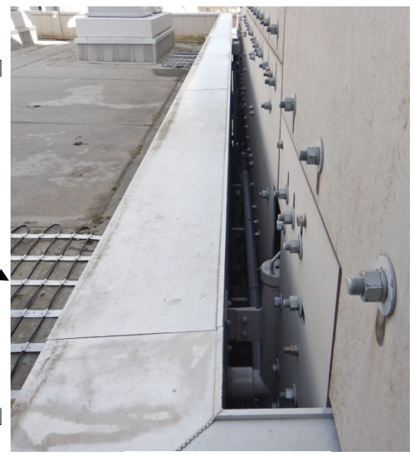
建屋近傍の隙間状況
